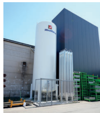
Reserva de nitrógeno de 41 m 3 y torre de almacenamiento automático Kardex para plantillas y pequeñas series de piezas
